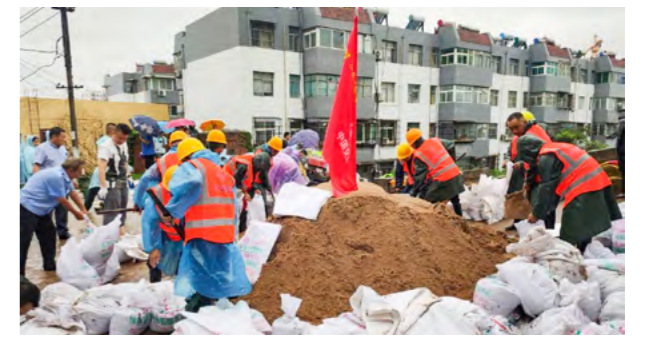
中交路建洛阳项目部迅速组成由30余名项目职工和劳务工人组成的防汛突击队参与防汛抢险，并筹集铁锹、救生衣、医药箱等物资全力支援当地防汛工作
